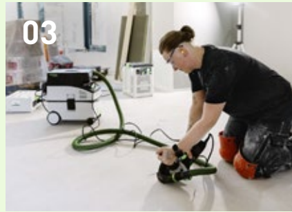
03 Slijp scheuren in de dekvloer of dichtgelopen uitzetvoegen open met de tegelslijper DSC AG 125 FH.
