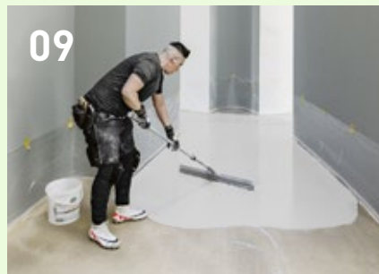
09 Giet het vloermateriaal op de ondergrond en verdeel het met een rakel gelijkmatig. In het geval van Pandomo Floor Plus wordt in het vloermateriaal hardkorrelig zand gestrooid.
