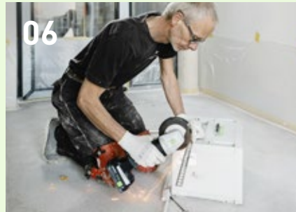
06 Slijp aansluitstrips met de haakse slijpmachine AGC 18 op maat plamuur ze als uitzetvoegen in de vloer.
